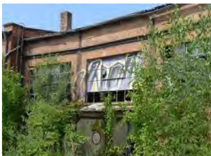
Schlechter Zustand: Der alte Lokschuppen im südlichen Areal
