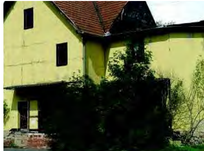
Mangelhafte Bausubstanz im Gebiet
