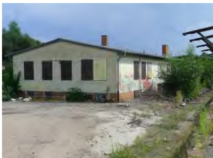
Schlechter Gebäudezustand: Der Gebäudeanbau an der Stückguthalle
