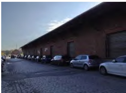
Mäßiger Zustand: Die leerstehende Stückguthalle, Parken entlang der Laderampe
