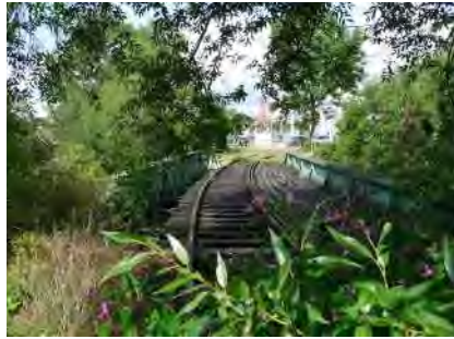
Ehemalige Bahngleise über die Itz (SÜC-Brücke) sind bereits teilweise zugewachsen
