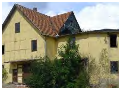
Sehr schlechter Gebäudezustand: Am Güterbahnhof 9
